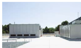
大容量蓄電システム(山口工場)
