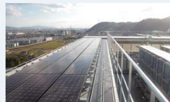
太陽光発電パネル(水無瀬研究所)
