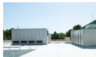
大容量蓄電システム(山口工場)
