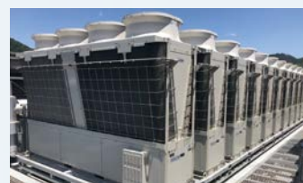
モジュールタイプヒートポンプチラー (水無瀬研究所)
